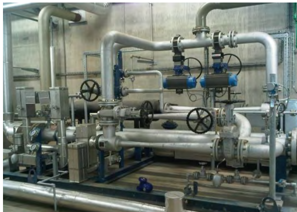
Photo 3 : éjecteur installé : www.kinetic-therm.com - crédit UNGDA
